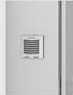
VENTILADORES DE ENFRIAMIENTO
